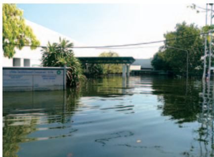
浸水したDCT正門
